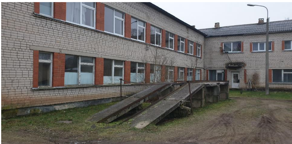
7.attēls. Lokālpilnojumā teritorijā esošā divstāvu ēka, kas veido pamata apbūvi plānošanas teritorijā.
